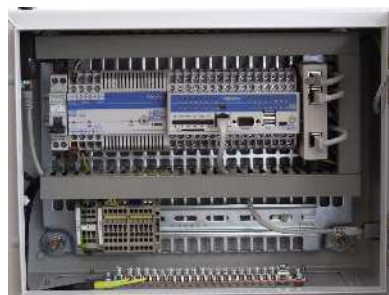
Module contrôleur du TGE
