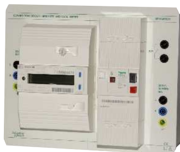
Disjoncteur de tête
