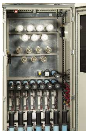
Armoire éclairage ouverte
